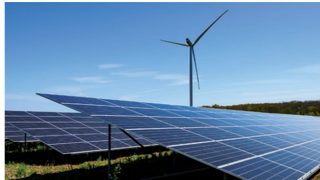
Wind-PV-Kombiprojekt im Güterverkehrszentrum Rostock
