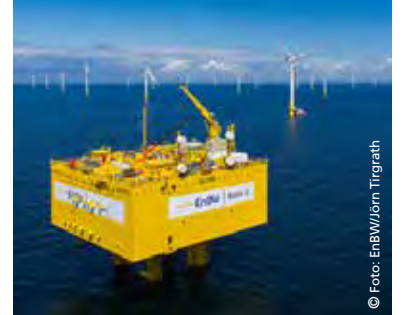
Umspannplattform des Offshore-Windparks EnBW Baltic 2 in der deutschen Ostsee
